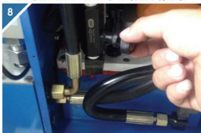
8 如果系统压力过冲过大，可以通过调节机箱内的溢流阀来调整过冲，顺时针增加过冲值，逆时针调整减少过冲值。
